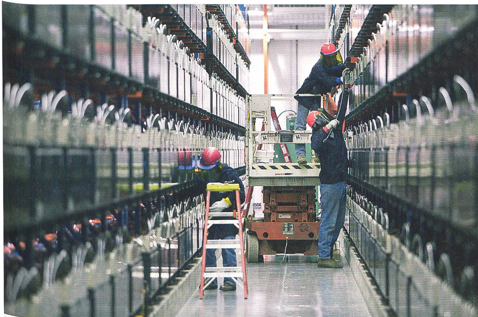
Bild 1 Weltgrösstes Batteriespeichersystem in Alaska. Das BESS (Battery Energy Storage System; 27–46 MW), entwickelt von ABB und Saft, ist grösser als ein Fussballfeld und besteht aus 13 760 Nickel-Kadmium-Energiezellen. Das System wurde im Auftrag der Golden Valley Electric Association (GVEA), einer Energiekooperative für die Gegend um Fairbanks, Alaska, gebaut und 2003 in Betrieb genommen. Das System liefert bei Stromausfällen bis zur Betriebsaufnahme der Reserveversorgung sofort und zuverlässig Strom und eliminiert damit den Bedarf an mitlaufender Reserve. Die Batteriezellen sind sicher, zuverlässig und am Ende einer zwanzigjährigen Betriebsdauer wiederverwendbar (Bild ABB).
