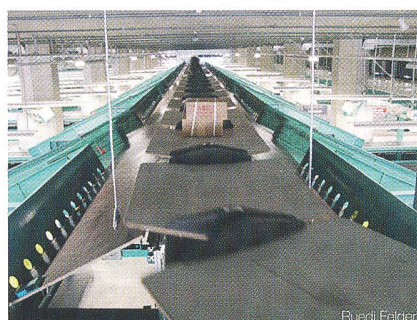
Die Gepäckabfertigung am Flughafen Kloten darf nicht stillstehen. Dazu braucht es aber keine teuren, proprietären Systeme, es reichen standardisierte SPS-Steuerungen.
