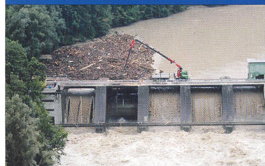
Gestautes Schwemmholz bei Bremgarten nach den ausserordentlichen Niederschlägen vom 22./23. August 2005.
