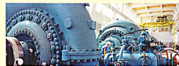
Turbinenanlage im Pumpspeicherkraftwerk Waldeck I (Bild Eon).
