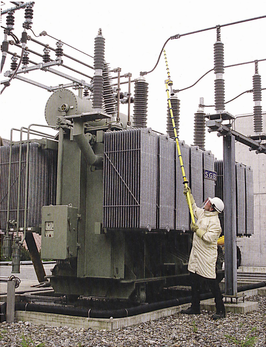
Das erfolgreiche Prüfen der Spannungsfreiheit in Hochspannungsanlagen sorgt für hohe Betriebssicherheit und Netzqualität (Bilder: ekz).
