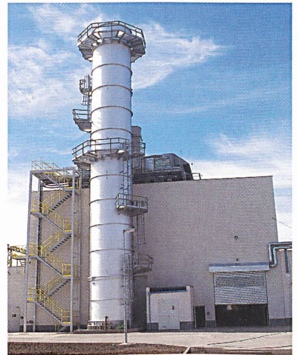
Das Gaskraftwerk von Kladno GT hat eine elektrische Leistung von 43 MW (Bild: atel).
