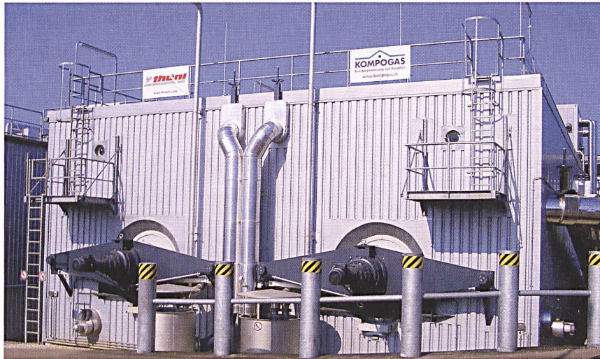
Fermenter mit Förderantrieb für Biomasse.
