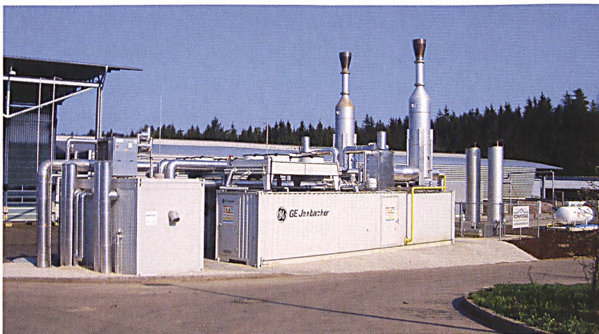
Blockheizkraftwerk mit zwei Gasmotoren/Generatoreinheiten.
