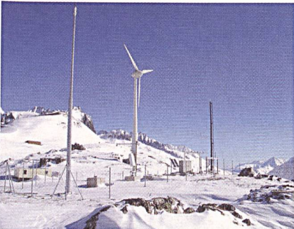
Höchstgelegene Windkraftanlage der Schweiz auf 2300 m ü.M. (alpine Test-Site Gütsch).
