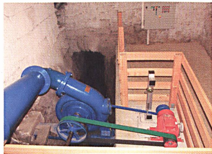
Generator und Steuerung der revitalisierten Wasserkraftanlage der Altbachmühle Wittnau (AG).
