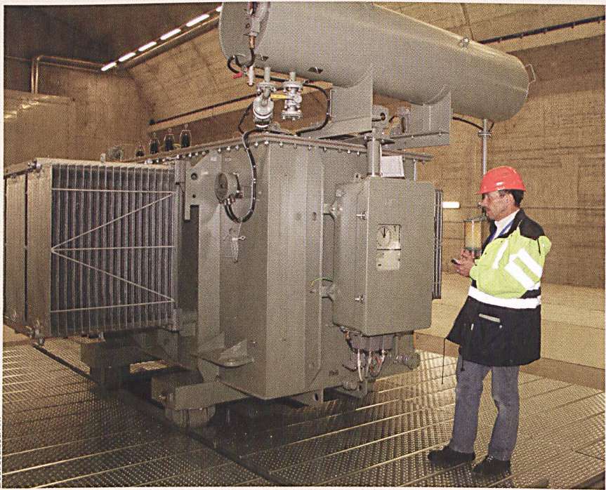
Kontrolle am Netzkupplungstrafo der Netze von BKW FMB Energie AG und der Energiedienste Visp – westlich Raron AG (EVWR).
