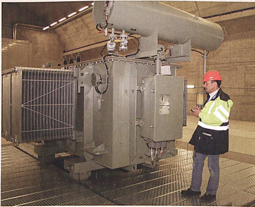
Kontrolle am Netzkupplungstrafo der Netze von BKW FMB Energie AG und der Energiedienste Visp – westlich Raron AG (EVWR).
