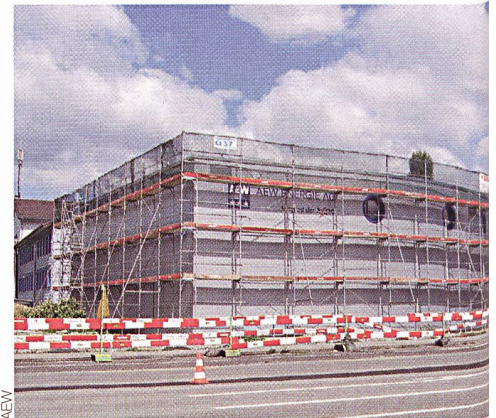
Neues Unterwerk in Rheinfelden
