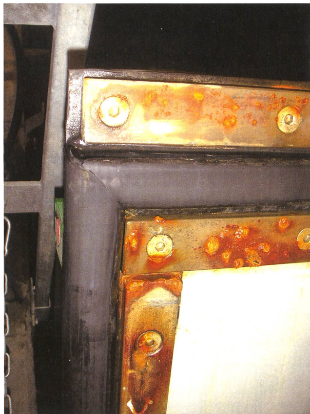
Bild 5 Korrosion an einem Segmentschütz mit starker Pustelbildung.
