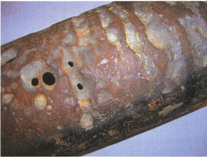
Bild 4 Korrosion durch Stromeinwirkung an einem duktilen Gussrohr.
