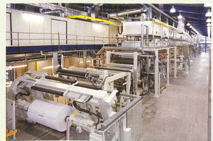
Profinet IRT synchronisiert die 100 m lange Beschichtungsmaschine auf 1 ms genau.
