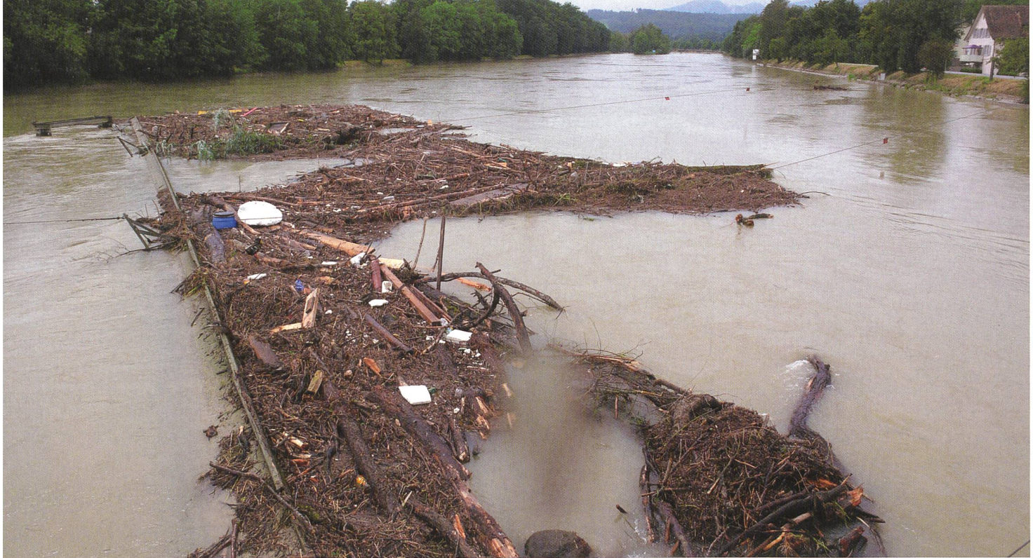
Schwemmholz im Kraftwerk Aarau am 10. August 2007.
