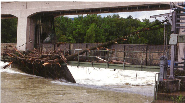
Schwemmholz an einer Brücke in Aarau am 10. August 2007.
