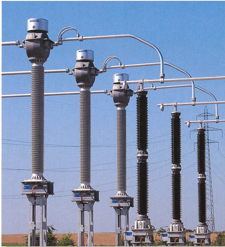
Umspannwerk Grans-près-Céligny (JOF300 und ECF300) Poste de Grans-près-Céligny (JOF300 et ECF300)
