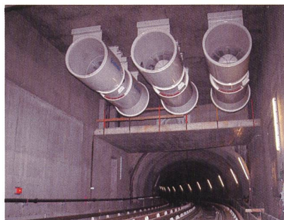
Le désenfumage du métro M2 à Lausanne.
