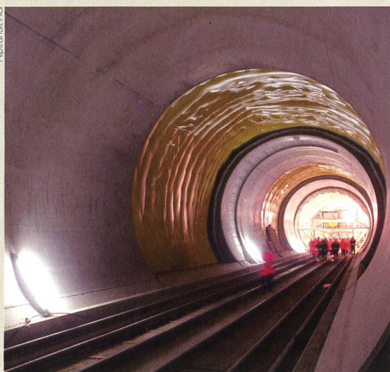
Die Energieverteilung im Tunnel muss gut projektiert werden.
