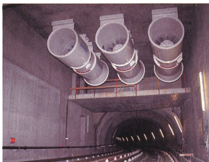
Le désenfumage du métro M2 à Lausanne.
