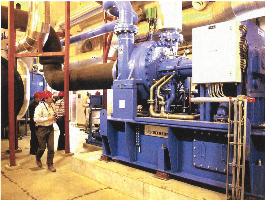
Bild 10 18,4-MW-Wärmepumpe der Viken Fjernvarme.
