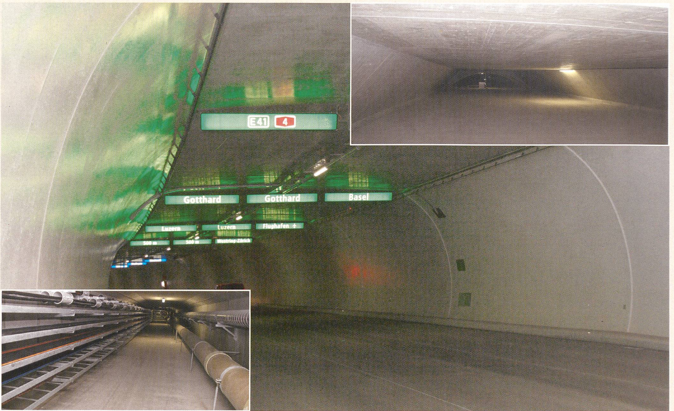
Wenn die Autofahrer ab Mai nächsten Jahres durch den Tunnel flitzen, werden sie kaum realisieren, wie viel Technik sich auch ober- und unterhalb der Fahrbahn befindet. Kleines Bild oben rechts: Auch über der Fahrbahn kann man noch knapp aufrecht gehen und hat zum Beispiel Zugang zu den Abluftklappen. Kleines Bild unten links: Werkleitungskanal unter der Fahrbahn. In der Westumfahrung Zürich wurden etwa 25 000 Kabel mit einer Gesamtlänge von ca. 3500 km verlegt.
