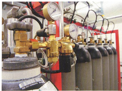
Druckbehälter der HI-FOG-Sprühfutanlage GPU 500 von Contrafeu.
