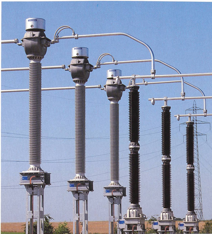
Umspannwerk Crans-près-Céligny (JOF300 und ECF300) Poste de Crans-près-Céligny (JOF300 et ECF300)
