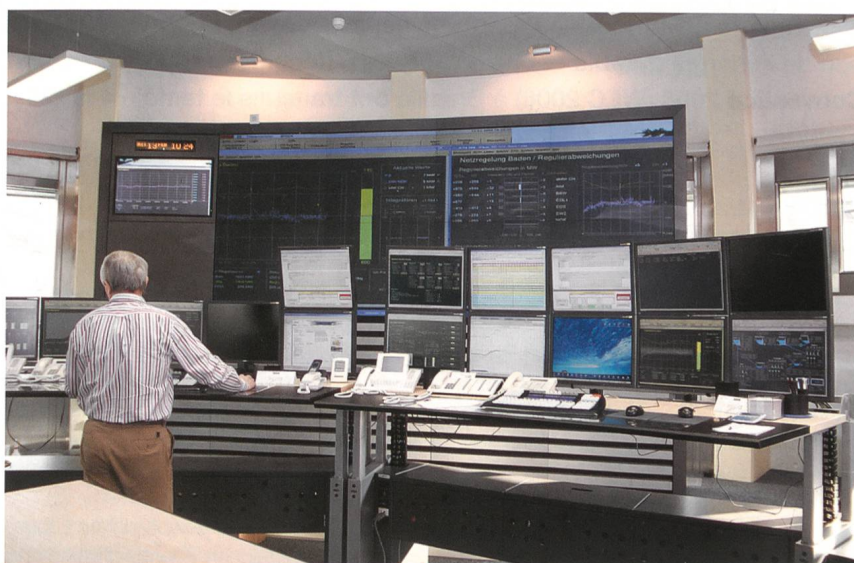
Arbeitsplätze des operativen Kraftwerkeinsatzes mit Grossbildprojektion.
