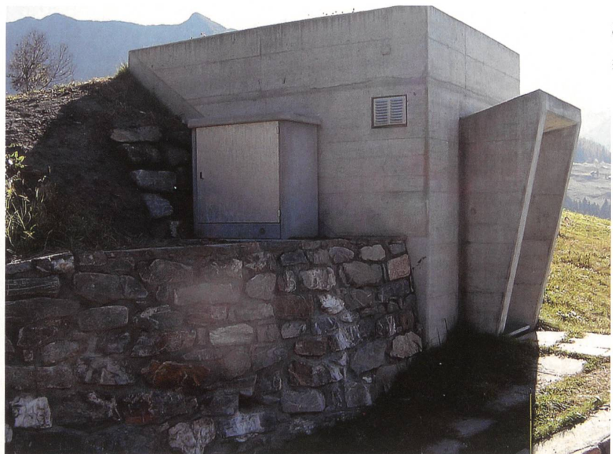
Das Reservoir im Dorf Riein. An der linken Seitenwand wurde im Herbst der Trafo angebracht. Im Innern wird im Frühling die Turbine installiert.
