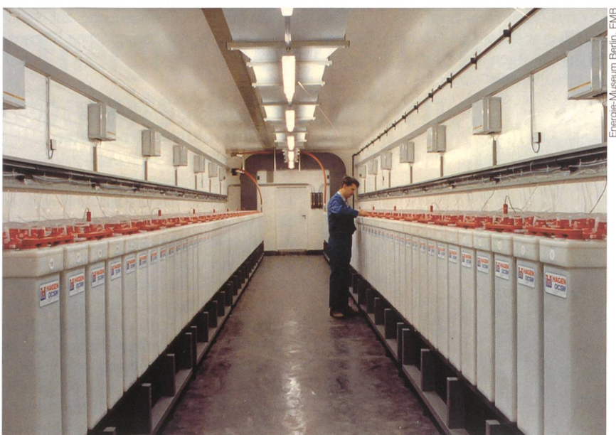
Bild 3 Teil der Batterieanlage im früheren Westberlin. Gesamtleistung 17 MW, Kapazität 14 MWh.
