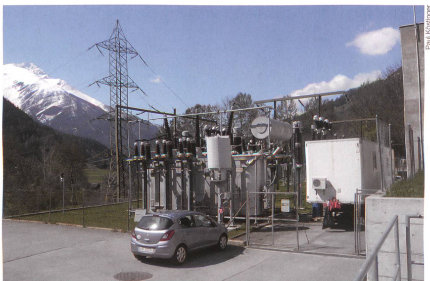
Bild 3 Moderne Ölregenerieranlage mit integrierter Wiederaufbereitung der Fullererde.
