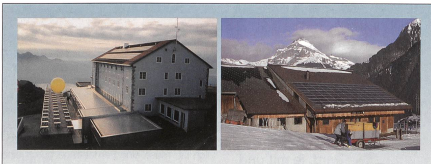
Bild 3 Fotovoltaikanlagen Rigi-Kulm und Gurtellen.
