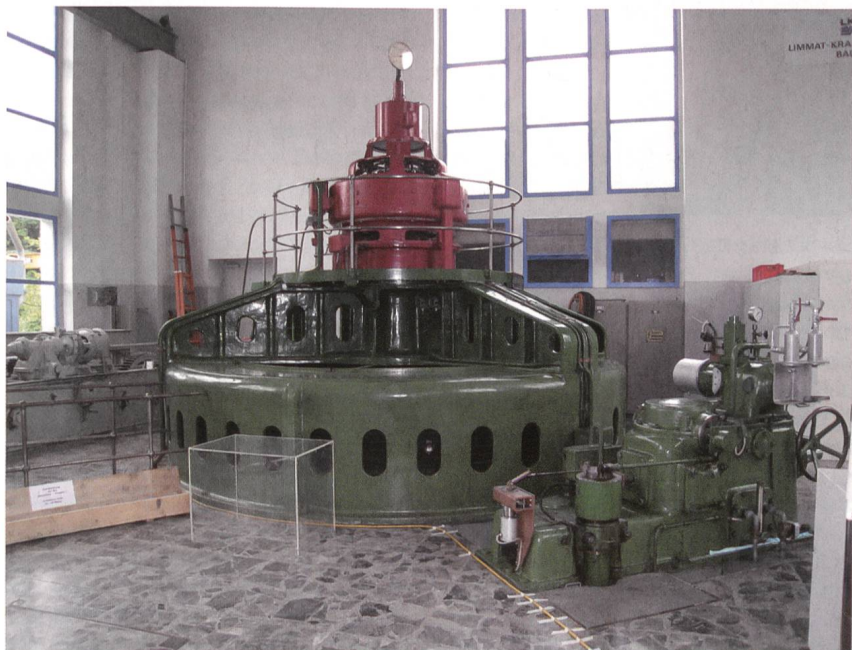
Maschinengruppe 3 des Kraftwerks Aue, Baujahr 1925, mit Francisturbine 1,2 MW und Generator 1800 kVA.
