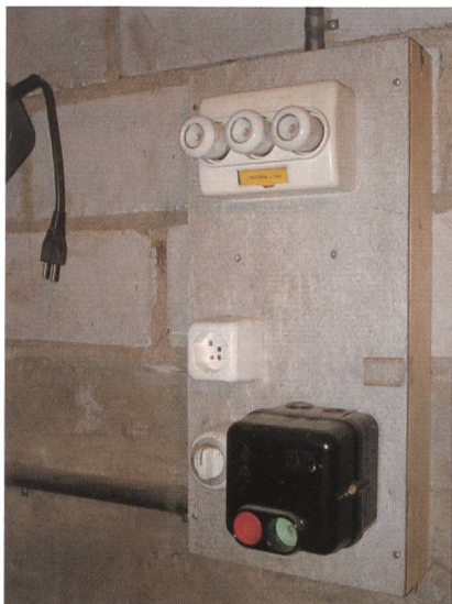
Bild 2 An diesem Heizungstableau wurden der Übergangsstecker und das Verlängerungskabel eingesteckt.
