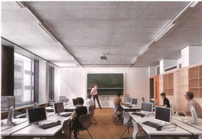
Tageslichtsteuerung und Anwesenheitssensor von Zumtobel reduzieren den Energieverbrauch in einem Klassenzimmer beachtlich.
