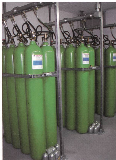
In den Bergeller-Kraftwerken des EWZ sind die bisherigen CO 2 -Löschanlagen mit neuen Argonite-Feuerelöschsystemen von Contrafeu ausgestattet worden.
