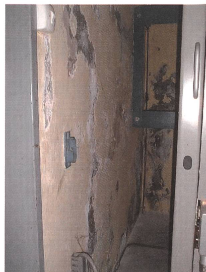
Bild 4 Wandschaden durch Feuchtigkeit im Baukörper einer Trafostation.
