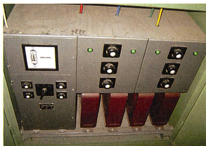
Eine Blindstrom-Kompensationsanlage mit der dazugehörigen Steuerung.
