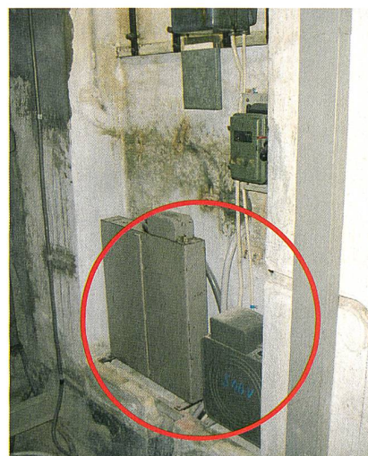
La photo montre les condensateurs de la compensation d'énergie réactive (cercle).
