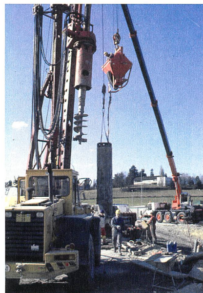
Bild 2 Installation des als Wärmetauscher eingesetzten Fundationspfahls, ausgerüstet durch die Equipe von Professor Lyesse Laloui (ETHL).
