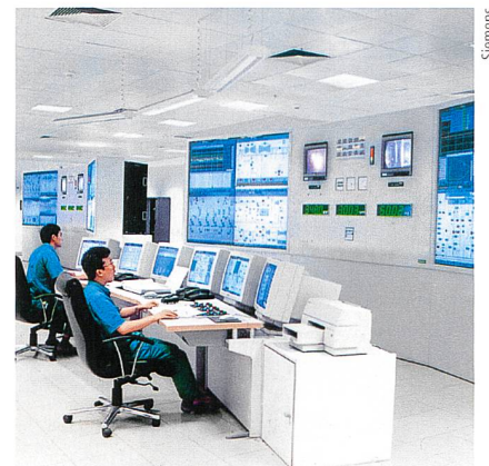
Software von SCS Info Tech ermöglicht die permanente Stromüberwachung.
