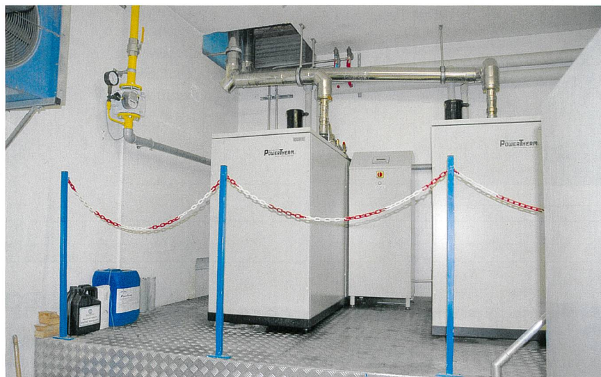
Figure 1 Couplages chaleur-force du centre de dispatching de Gaznat à Aigle.
