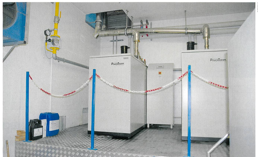
Figure 1 Couplages chaleur-force du centre de dispatching de Gaznat à Aigle.
