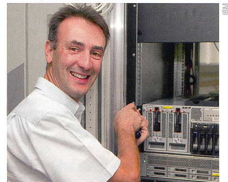
Le nouvel IBM Power 755 est installé à Lugano.
