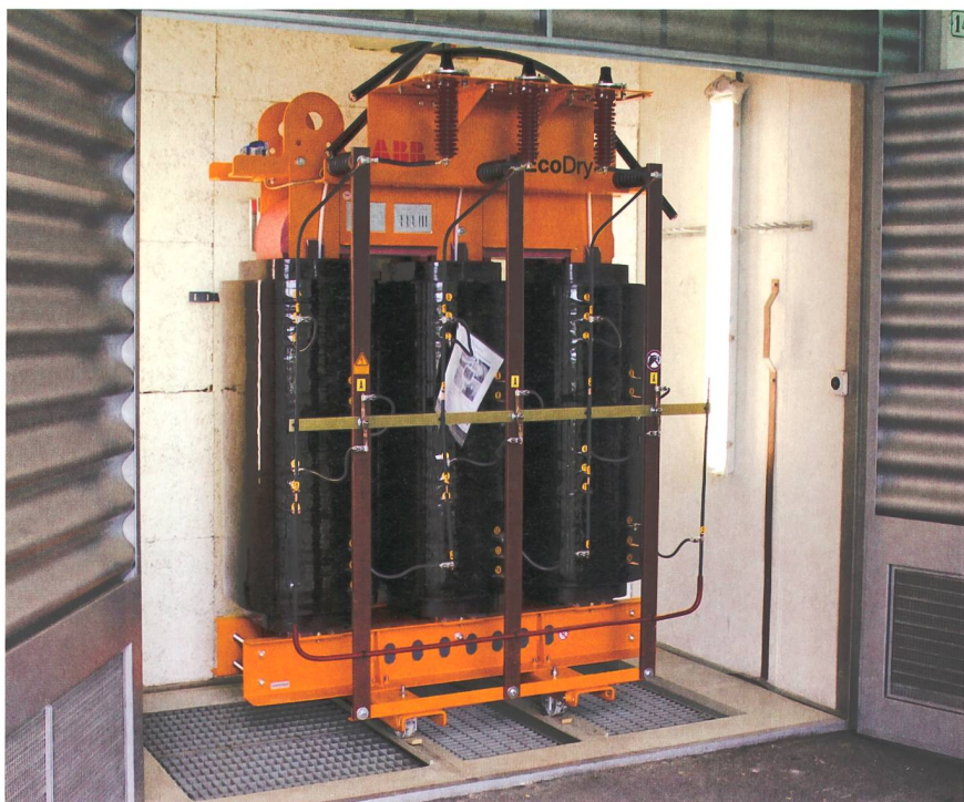
Figure 5 Transformateur amorphe EcoDry installé à ewz à Fällanden.
