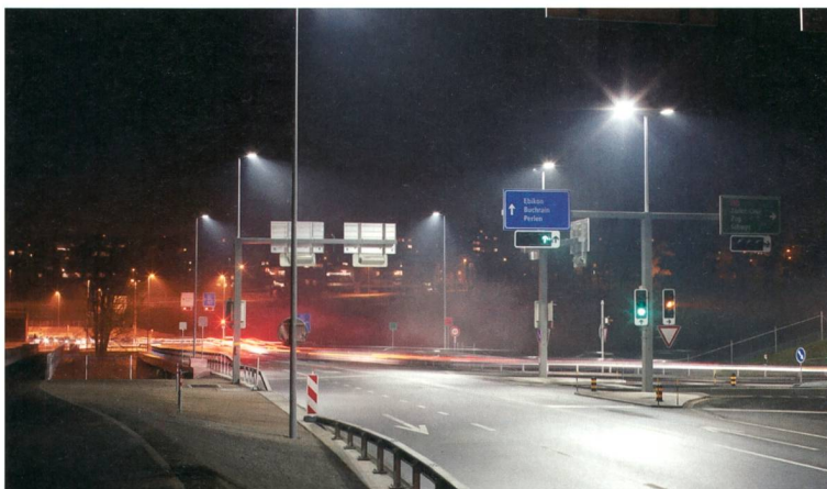
Das Beleuchtungssystem der Siteco Schweiz AG garantiert eine homogene, blendfreie Lichtverteilung.
