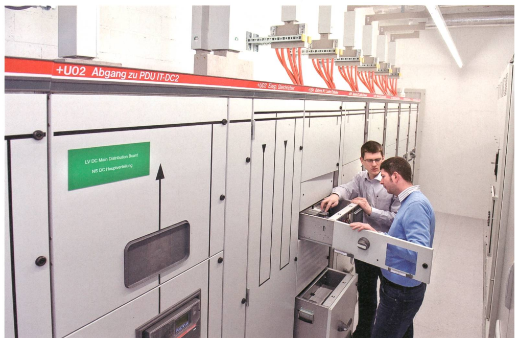
Bild 1 ABB-Mitarbeiter der Geschäftseinheit Niederspannungssysteme im Gleichstrom-Versorgungstrakt im Rechenzentrum der Green Datacenter AG.
