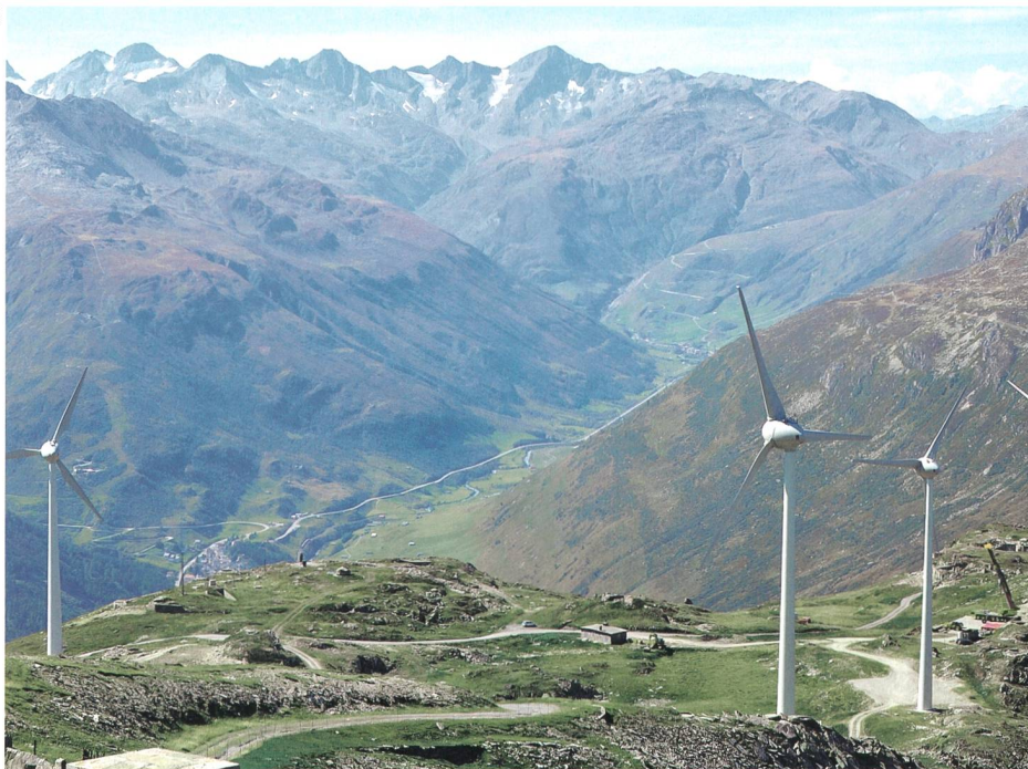
Bild 5 Gesamtsicht des Gütsch-Windparks. Links ist die älteste Anlage, die neu errichtete Windkraftanlage ist rechts hinten sichtbar.
