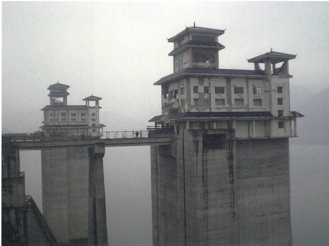
Bild 2 Einlaufbauwerke für die Zipingpu-Stauanlage mit beschädigten Bedienungsgebäuden (Wenchuan-Erdbeben 2008, Sichuan, China).
