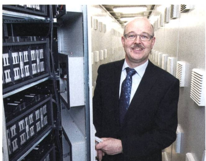
Bild 3 Bruno Völlmin, Projektleiter des Batteriespeichers der EKZ, mit offenem Rack.
