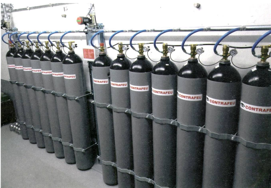
Stickstoffflaschenbatterie für zwei Löschbereiche mit mechanischer Blockiervorrichtung.
