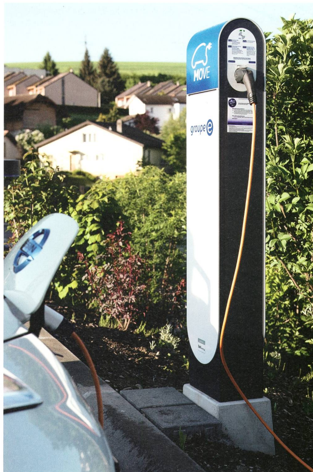
Figure 1 Une borne de recharge rapide du réseau MOVE.
