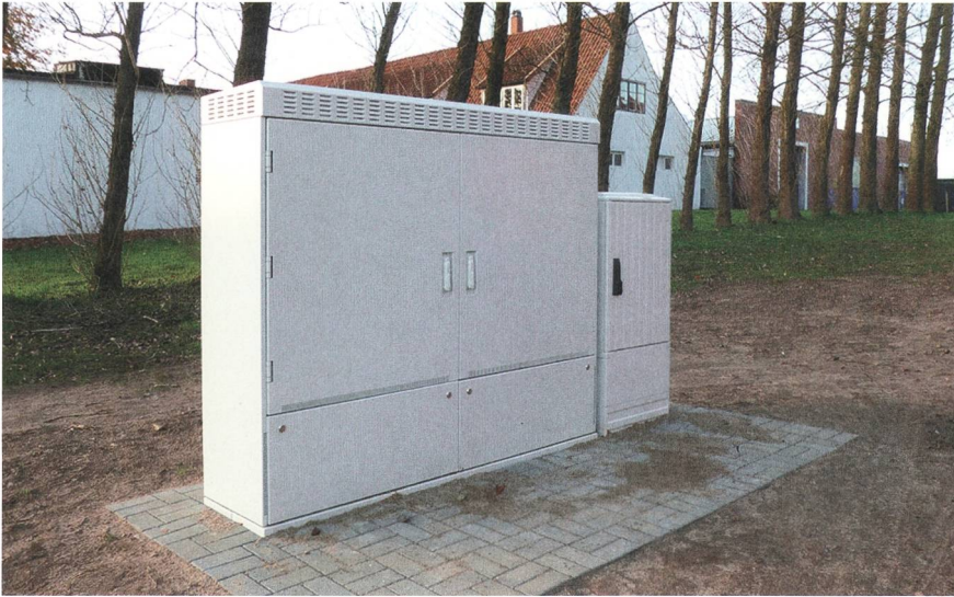
CCM-Aussengehäuse MFG 18 mit externer Zähleranschluss säule.
