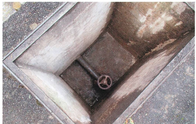
Schacht mit Entleerungsschieber der Druckleitung.
