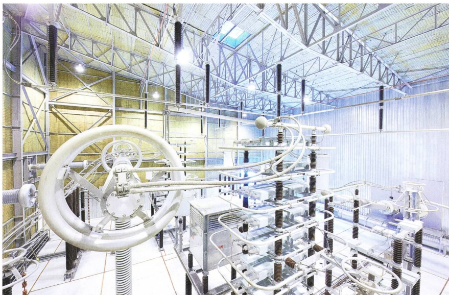
Eine HGÜ-Umrichterstation von ABB.
