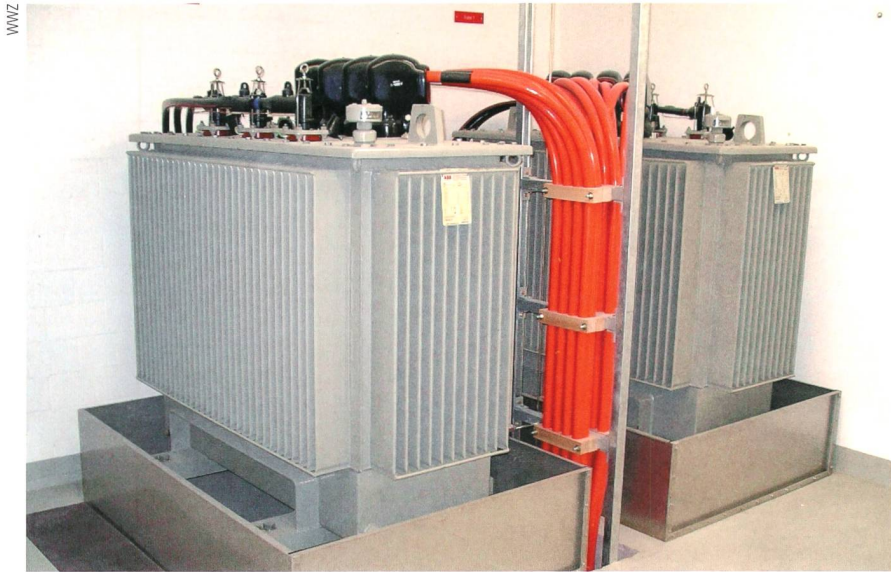
Bild 4 Ölgefüllte Verteiltransformatoren in Trafostation.
