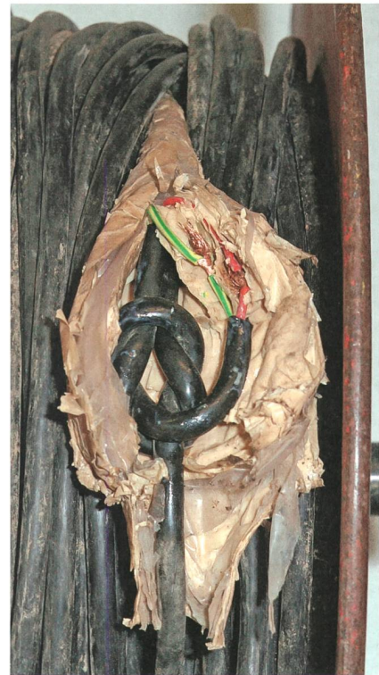
Travaux mal exécutés sur des installations ou appareils électriques par des non professionnels peuvent être mortels – Bobine de câble sous tension.
