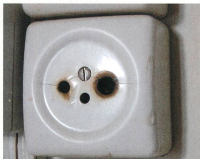
Vecchi impianti elettrici.
