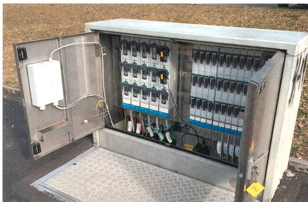
Bild 3 Beispiel einer Installation in einer Verteilkabine.
