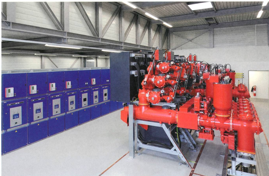
Bild 2 Ferngesteuerte Schaltanlagen des Unterwerks Rafz.
