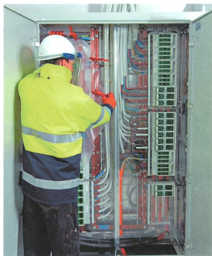
Immagine: lavorare sotto tensione.
