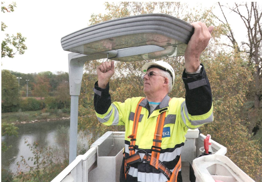
LED-Strassenleuchten sind an sich schon energieeffizient. Werden sie verkehrsabhängig gesteuert, erhöht sich die Effizienz noch.
