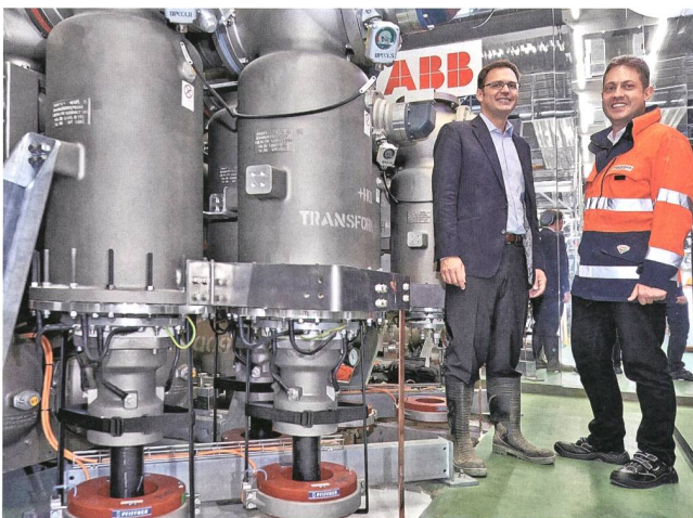
Pascal Müller, Gesamtleiter des neuen Unterwerkes Oerlikon (links) und Reto Aeschbach, Verkaufsleiter bei der Pfisterer Sefag AG (rechts) freuen sich über die gelungene Fusion umweltfreundlicher Technologien: trocken isolierte HV-Connex-Kabelanschlüsse von Pfisterer im Einsatz an ökogasolierter HV-Schaltanlage von ABB.
