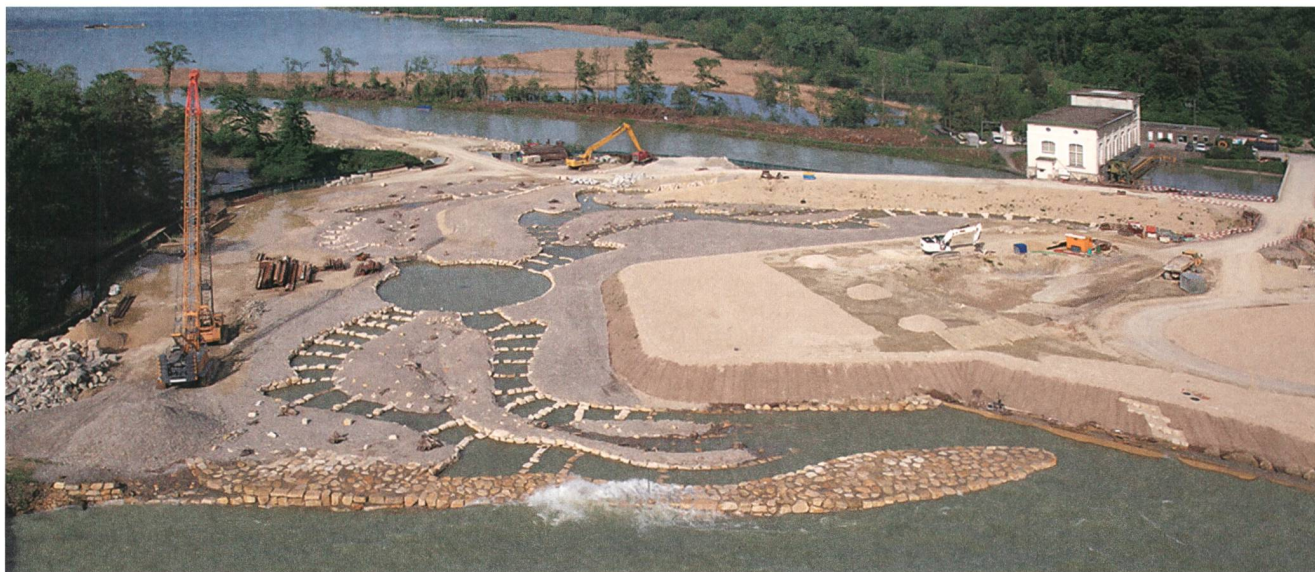
Bild 4 Viel Raum wurde der Fischgängigkeit eingeräumt. Hinten sieht man das alte Kraftwerk.
